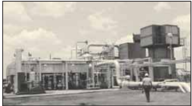
Fig. 5-18. Miniplanta de gas en las operaciones petroleras en el sur del estado Monagas.
