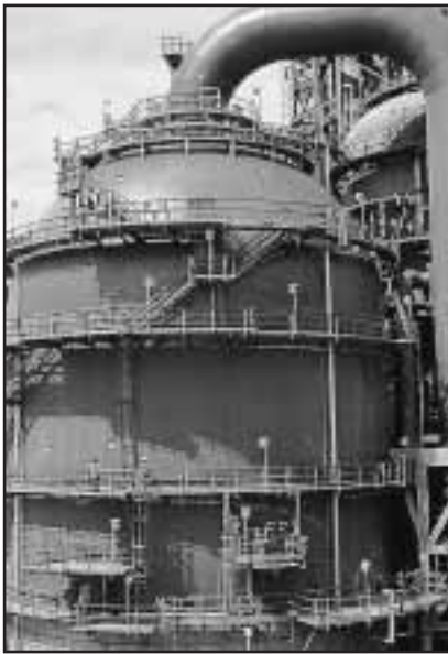
Fig. 6-38. Planta Flexicoker del nuevo patrón en Amuay, Centro de Refinación Paraguaná, estado Falcón, para entonces (1982) la más grande en su tipo en el mundo. Permite convertir asfaltos en gasóleos, naftas, gases y coque.
