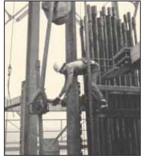
Fig. 12-55. Faena del encuellador en un taladro de perforación.
