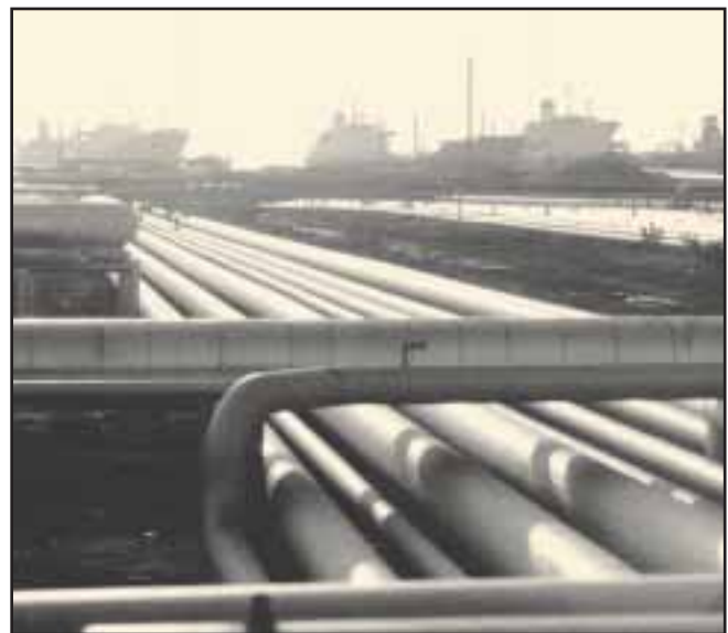
Fig. 8-12. Tuberías de diversos diámetros y especificaciones son requeridas para manejar los crudos desde los campos a las terminales y refinerías.
