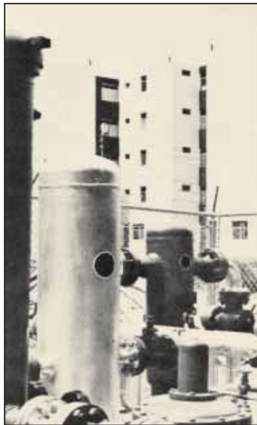
Fig. 5-29. Instalaciones para distribución de gas doméstico en La Haciendita, Cagua, estado Aragua.
